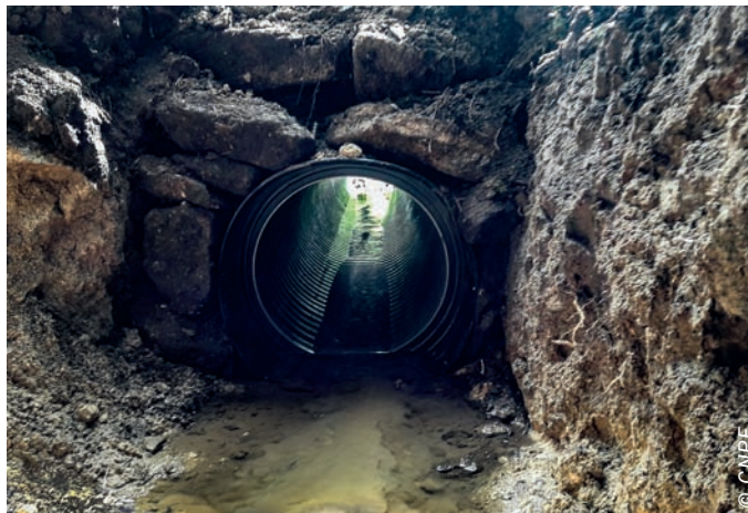
Buse non enterrée dans le cours d'eau empêchant la bonne circulation de l'eau.
