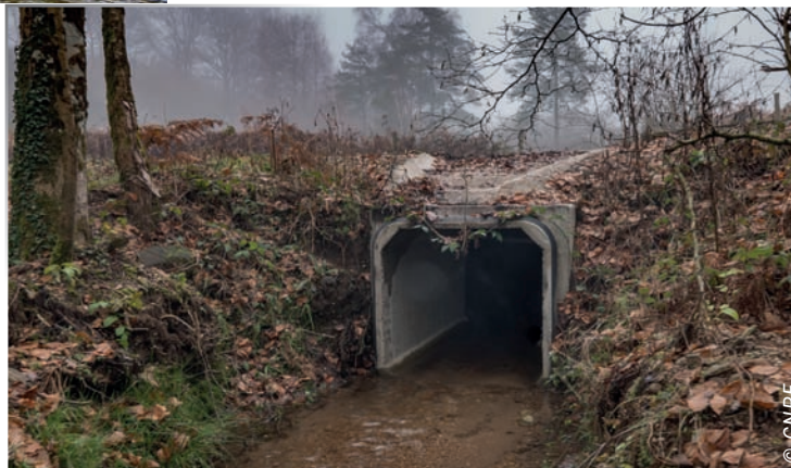
Passage busé de bonne dimension et installé correctement
